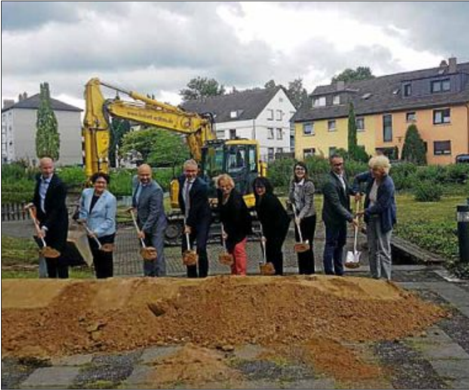
Am Montag dieser Woche wurde zum Spaten gegriffen für die „Neuausrichtung des Beruflichen Bildungszentrums, 1. Bauabschnitt“.
