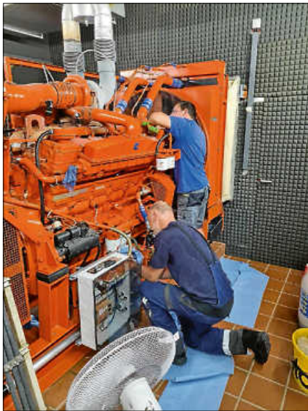
Generatoren wie dieser, der in einem Wasserhochbehälter für Kontinuität im Krisenfall sorgt, garantieren Versorgung bei Engpässen Foto: Stadtwerke Ettlingen
