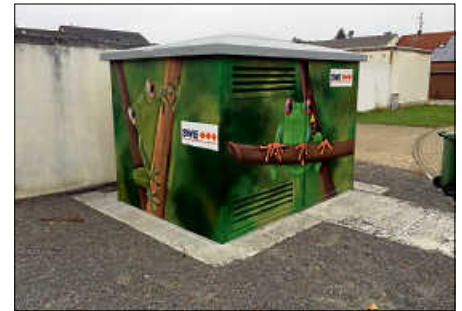
„Frosch-Station“ der Stadtwerke in der Adlerstraße Foto: Georg Reiser
