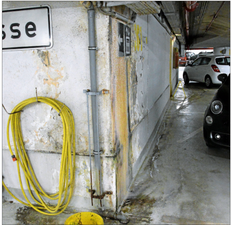
Manche Wände in der Tiefgarage Neuer Markt erinnern wegen des beständig tropfenden Wassers an Kalkhöhlen. Die Frage stellt sich deshalb, wie sieht es dahinter und darüber aus in der Decke.
